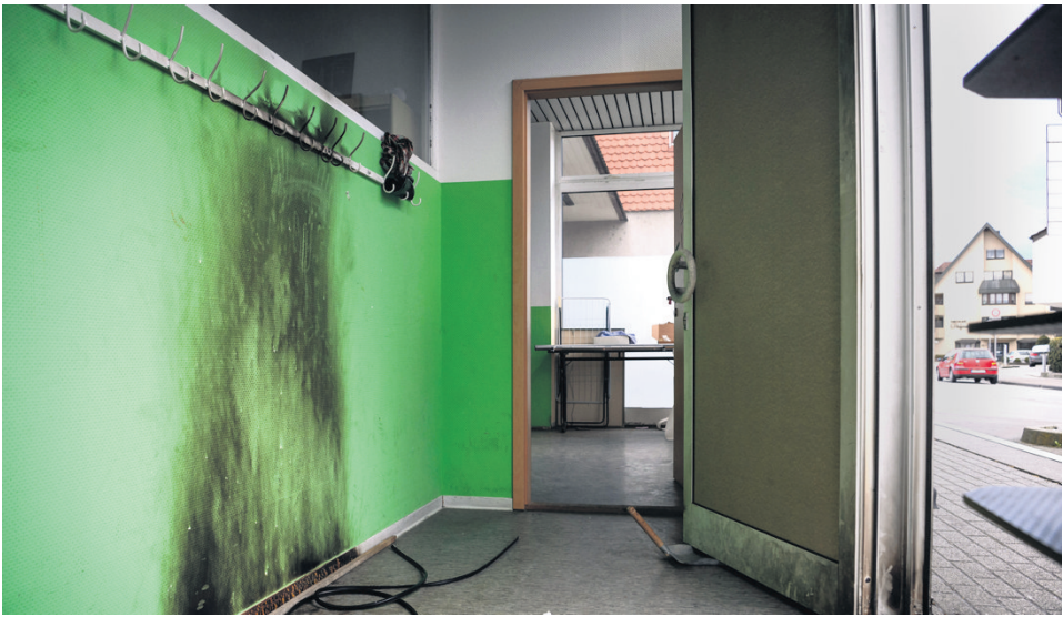
An einer Wand und an der Tür der Moschee sind noch die Brandspuren zu sehen, die der Anschlag verursacht hat.
